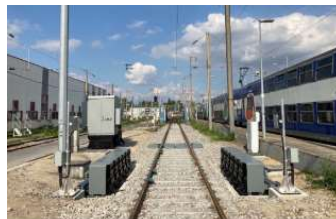
JONCHEROLLES, installé en septembre 2022
