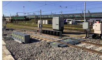
MONTROUGE, installé en octobre 2021
